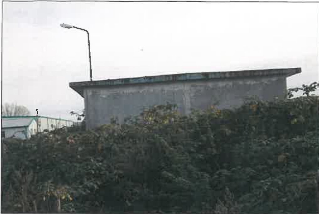
Abbildung 8: Transformatorhaus im Plangeitungsbereich, das vollständig Armenischen Brombeere ( Rubus armeniacus ) umwuchert ist
